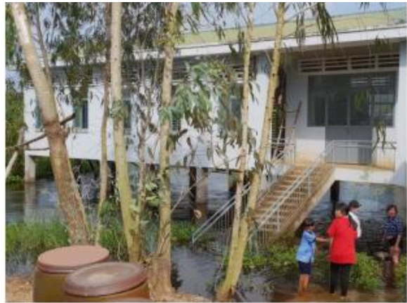
Trạm bơm nước khu A2
